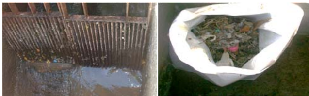
Figura 21 - Resíduos Sólidos interceptados na etapa de gradeamento do processo de tratamento de esgoto.
