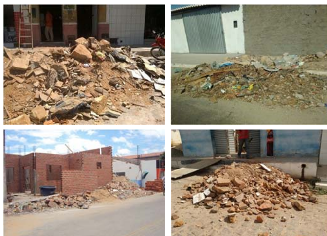
Figura 14 - Acúmulos de resíduos da construção civil nos municípios de Água Branca, Delmiro Gouveia, Olho d'Água do Casado e Piranhas.
