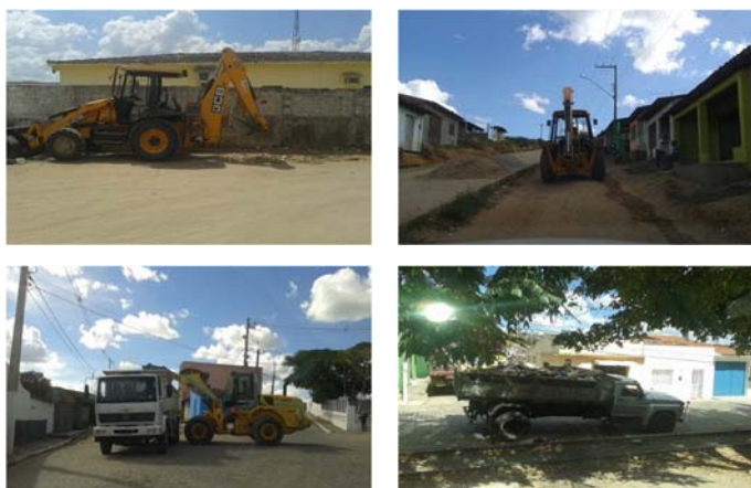
Figura 13 - Equipamentos e serviços de coleta de RCC em municípios da Região da Zona da Mata.
