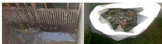
Figura 19 - Resíduos Sólidos interceptados na etapa de gradeamento do processo de tratamento de esgoto.
